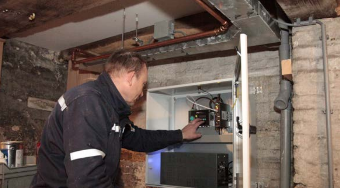
In de kelder van twee monumentale panden is meetapparatuur geïnstalleerd
